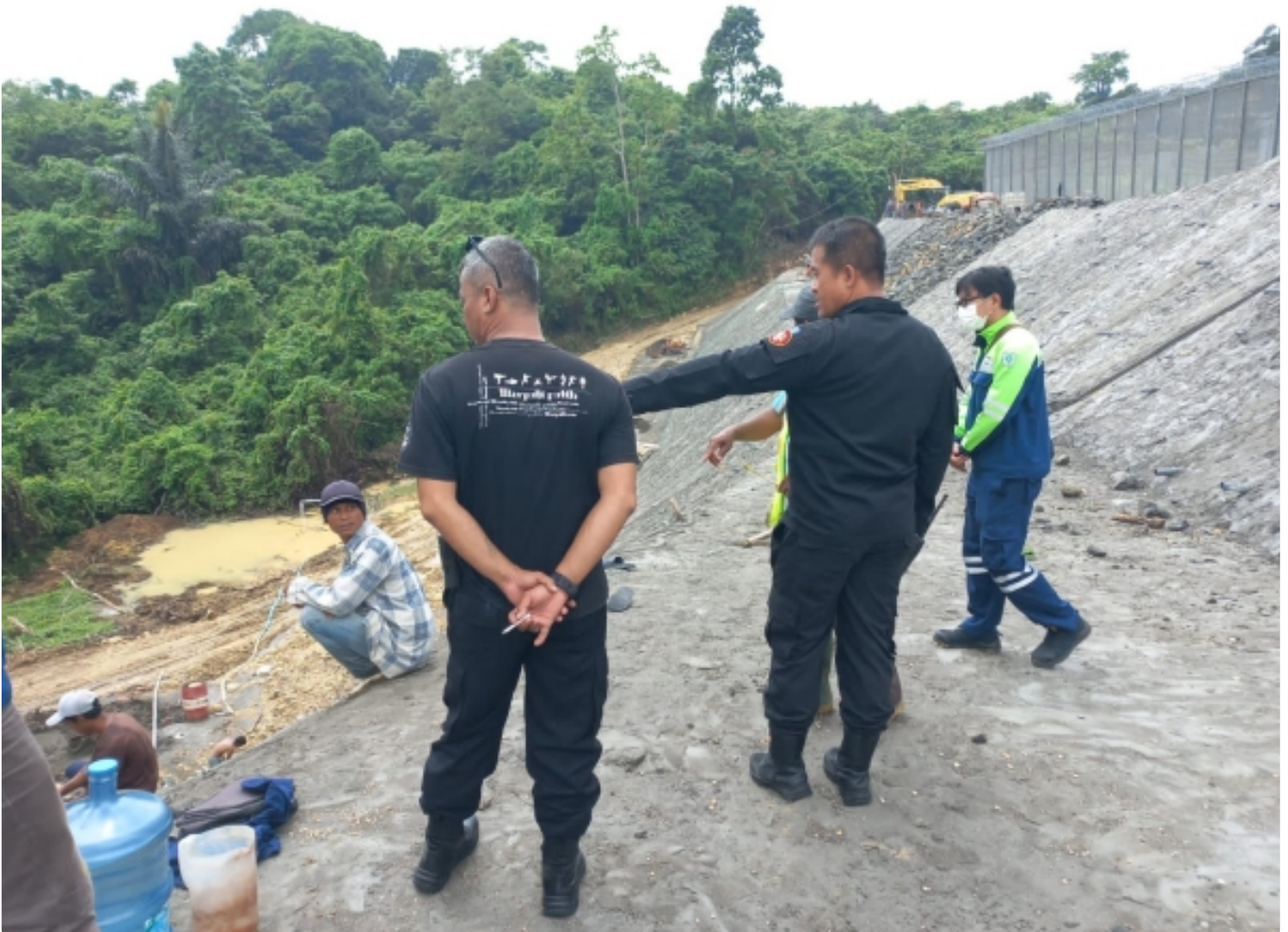
Garap Turap GRBB PT. SBI, Plt. Kalapas Karanganyar: Turap ini Sebagai Penahan Bencana Alam Tanah Longsor
